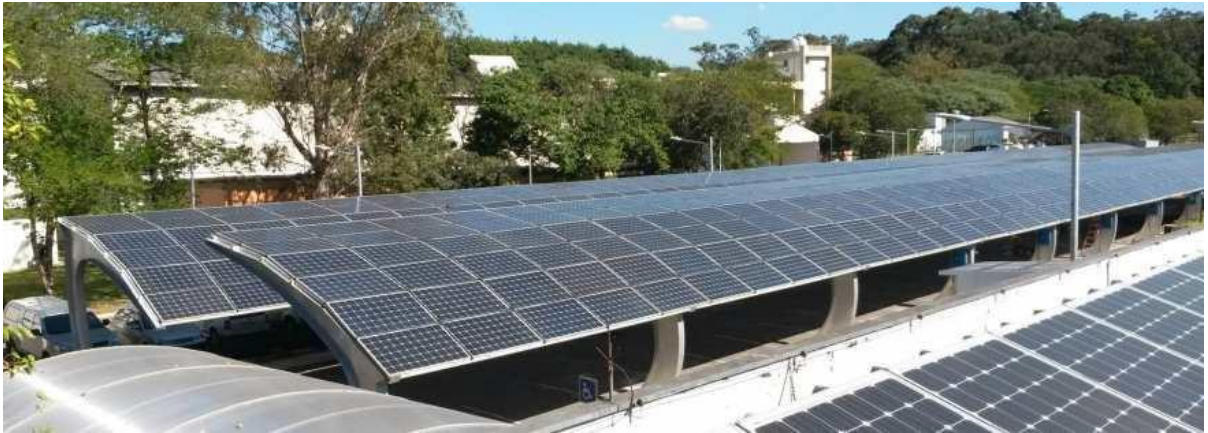
Figura 10 - Sistema instalado sobre o gramado do IEE, com potência instalada de 150 kWp
