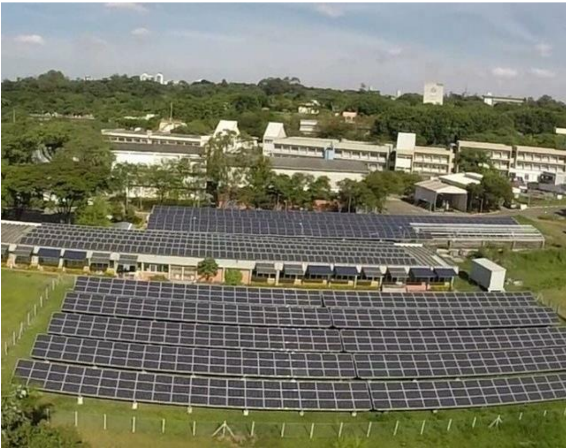
Figura 9 - Sistema instalado sobre o gramado do IEE, com potência instalada de 156 kWp
