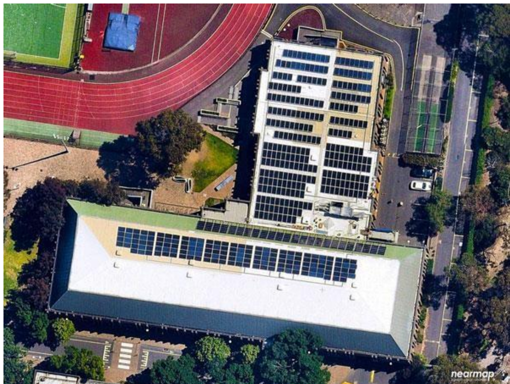
Figura 15 - Painéis Solares instalados na universidade de Melbourne
