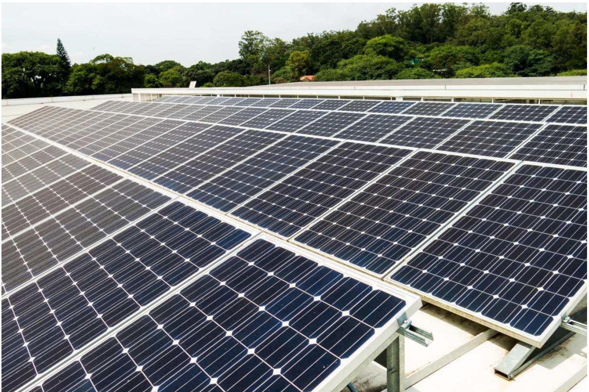
Figura 11 - Sistema instalado sobre a Biblioteca Brasileira Guita e José Mindlin, com potência instalada de 156 kWp
